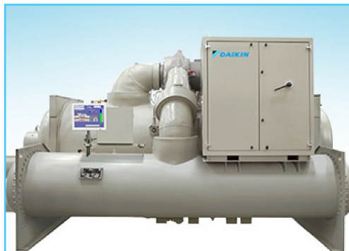
HỆ THỐNG CHILLER GIẢI NHIỆT NƯỚC 水冷式 Chiller 系统
