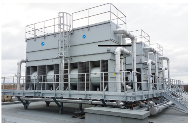
CUNG CẤP VÀ LẮP ĐẶT THÁP GIẢI NHIỆT NƯỚC 提供与安装冷却塔系统
